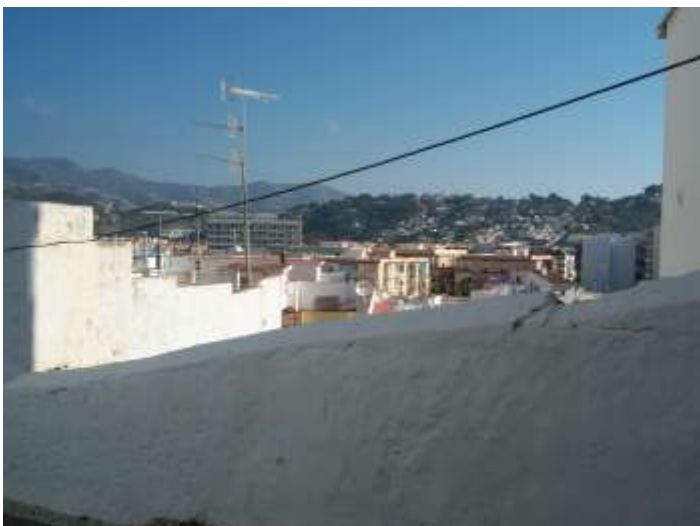
Cableados aéreos, antenas
