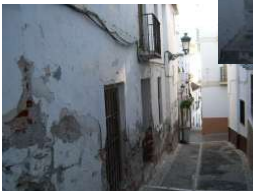
Viviendas en mal estado en Calle Morería
