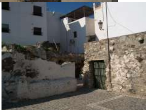
Viviendas en mal estado en Cueva Siete Palacios
